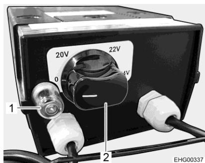
Kuva 119 Sähköisen lattialämmityksen säädin
