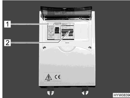
Kuva 109 230 V:n sulakerasia ja johdinsuojajytkin sekä FI-kytkin
